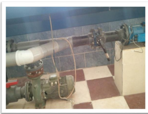
Figure 1.3 : Pompe centrifuge et vanne de régulation du débit
