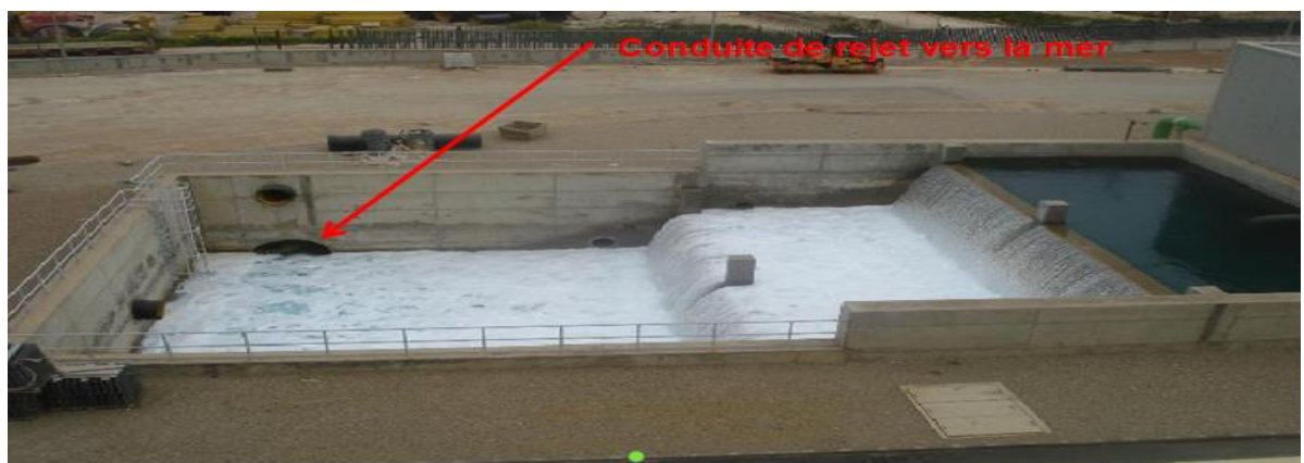
Figure IV .13: la conduite de saumure vers la mer
