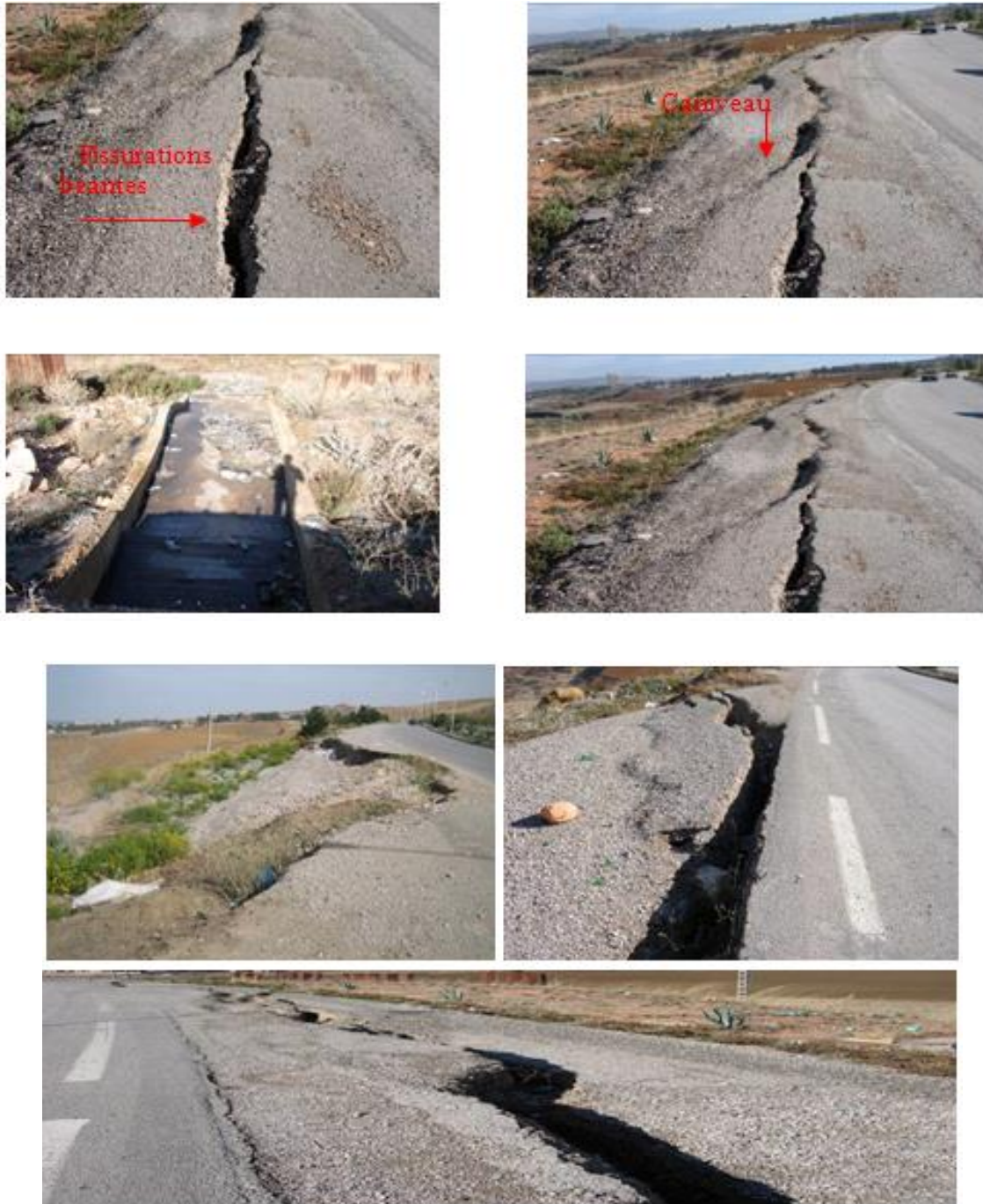
Figure 1.17 accétement dégradé par glissement de terrain
