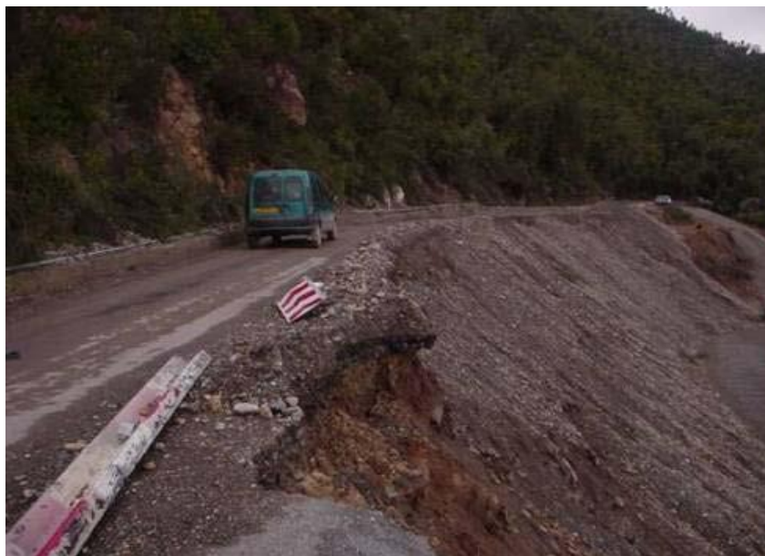
Figures 1.5 b vue du glissement
