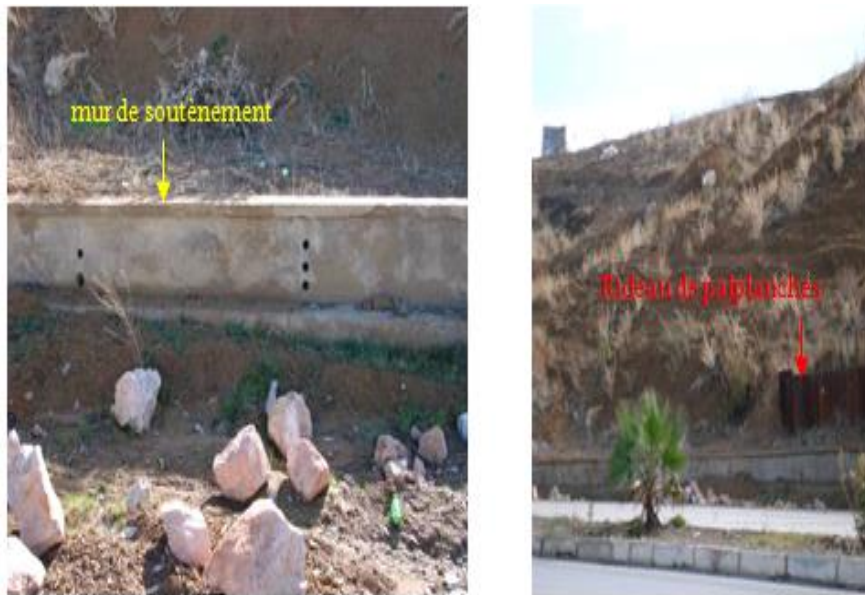
Figure 1.15 mur de soutènement affecté par glissement
