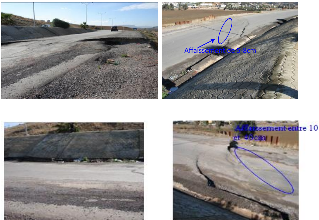
Figure 1.16 Dégradation de chaussé causé par glissement
