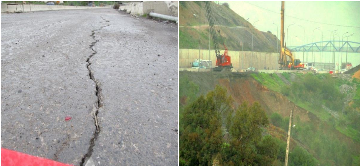
Figure4.23 Glissement du tronçon Buirra-Alger (Mars 2014).
