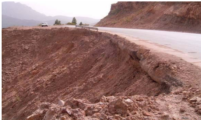
Figures 1.8b vues de la zone de glissement
