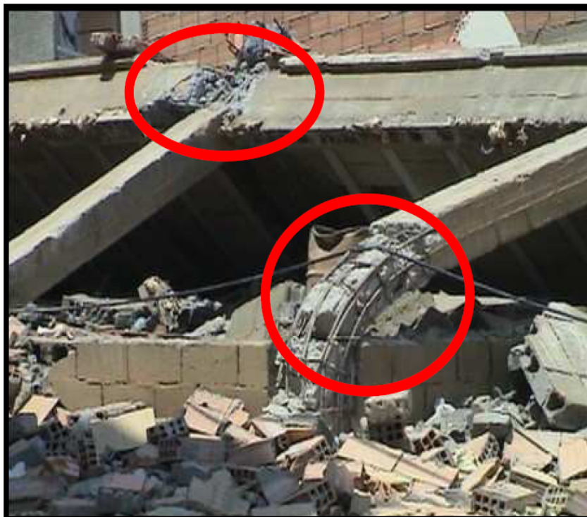
Figure III.19 : Exemple de dommages d'un bâtiment suite au séisme de Zemmouri 2003.
