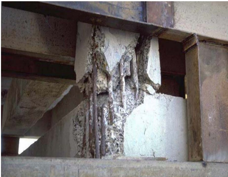
Figure III.27 : Ruine d'un nœud a la jonction poteau-poutre d'angle lors du séisme de Buhj (Inde) en 2001.
