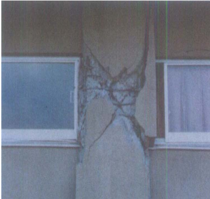
Figure III.24 : Rupture par cisaillement d'un poteau court en béton armé dans une école d'enseignement technique des chemins de fer lors du séisme de Miyagi-Ken en 1978.
