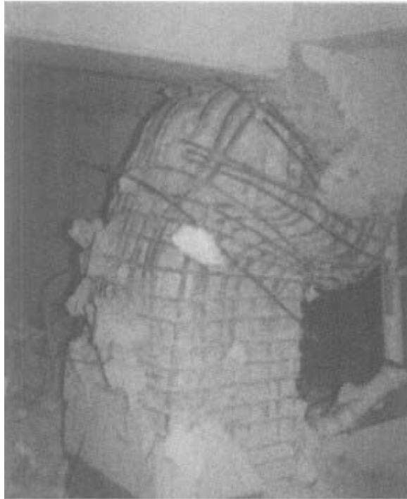
Figure III.22 : Ruine par flexion-compression d'un poteau en béton armé de 1m de diamètre dans le bâtiment (Motoyama Royal Condominium) lors du séisme de Kobe (Japon) en 1995.
