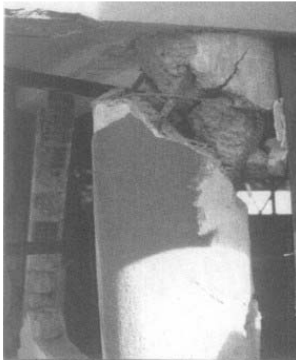
Figure III.23 : Rupture par cisaillement d'un poteau en béton armé lors du séisme de Kalamata (Grèce) en 1986.
