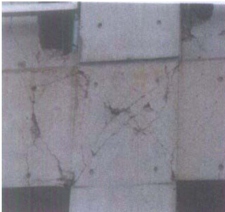
Figure III.25 : Endommagement d'un nœud poteau-poutre par cisaillement lors du séisme de Kobe (Japon) en 1995.
