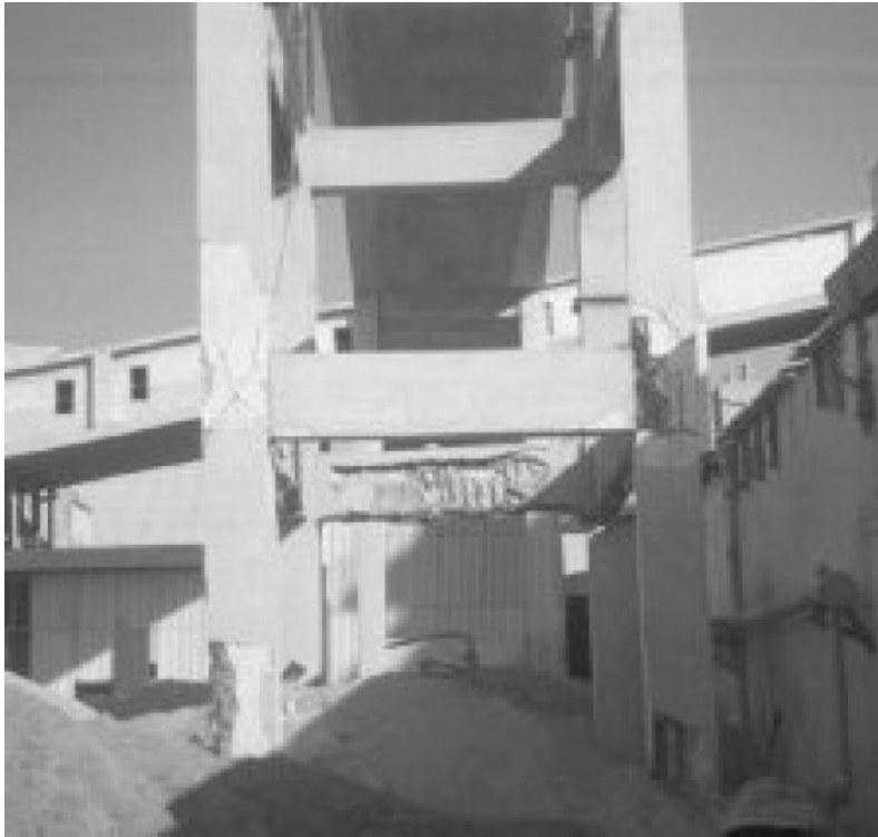
Figure III.26 : Endommagement des nœuds d'un portique dans une cimenterie lors du séisme Buhj (Inde) en 2001.
