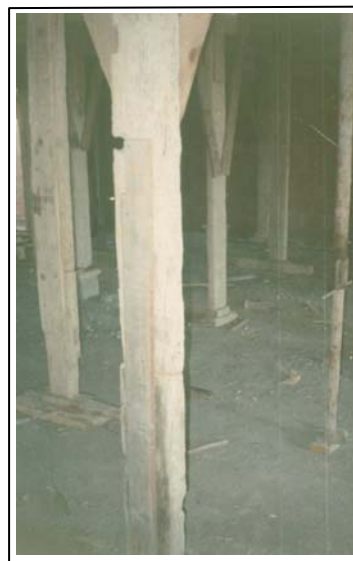
Photo V.12: Assemblage d'étais en bois considéré comme défectueux
