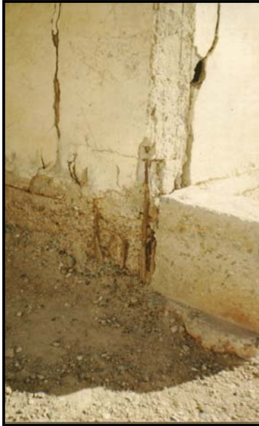
PhotoV.41: détérioration du pied de poteau.
