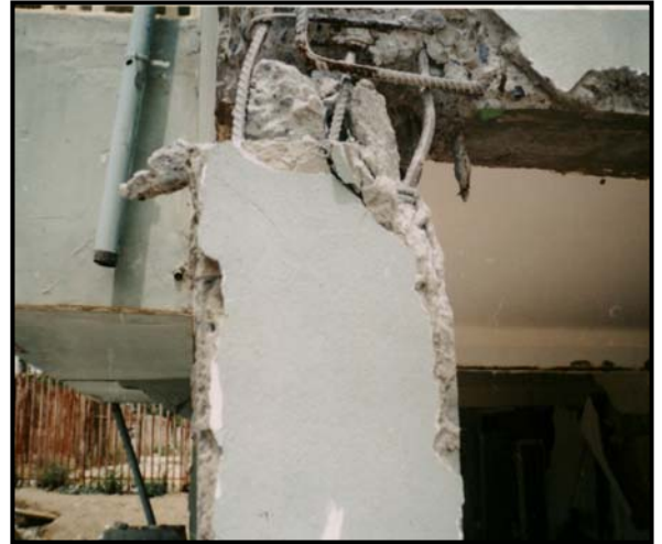
PhotoV.20: Destruction de l'extrémité du poteau d'angle à cause de l'absence d'armatures transversales.
