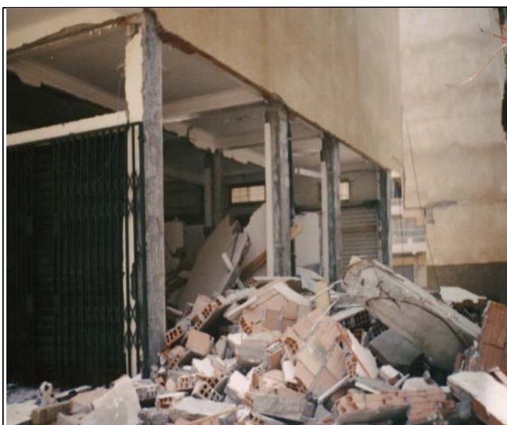
Photo IV.13: Renversement et chute des murs extérieurs et de séparation
