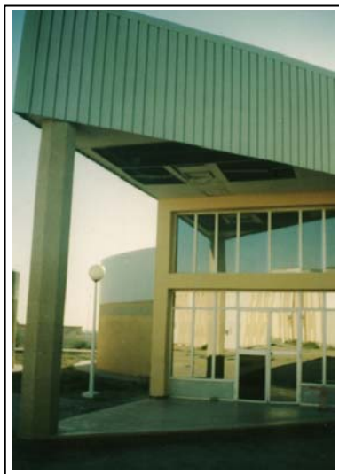
Photo V.4: La chute du faux plafond est due à un mauvais choix du matériau.
