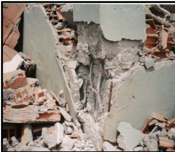
PhotoV.21: Endommagement du pied de poteau dû aux insuffisances de cadres.
