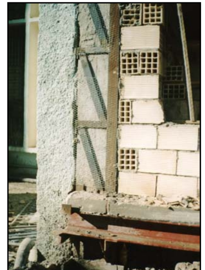
PhotosVII.13: Les fers plats assurent la stabilité des cornières
