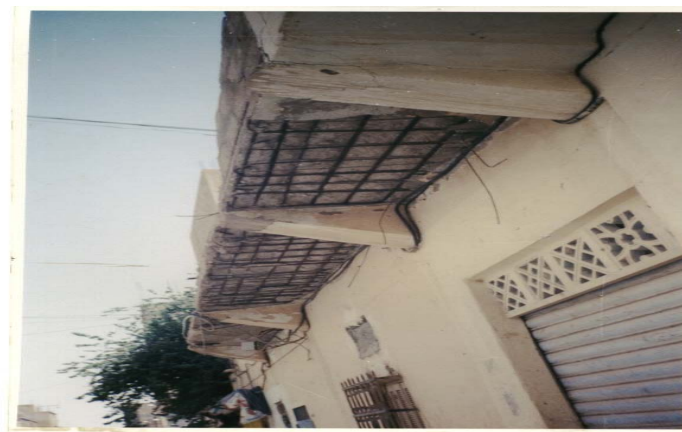
PhotoVI.6: Détérioration du balcon
