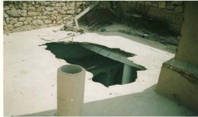
PhotoVI.4: Chute d'une partie de la dalle
