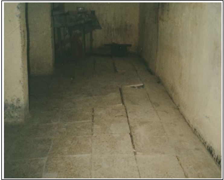
Photo IV.8: Le soulèvement du dallage a provoqué l'éclatement des carrelages.
