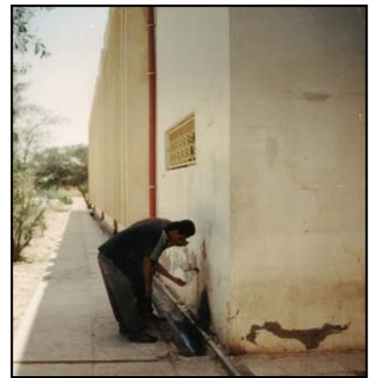
PhotoV.16: L'emplacement d'un robinet contre la construction peut être la cause de dégradation
