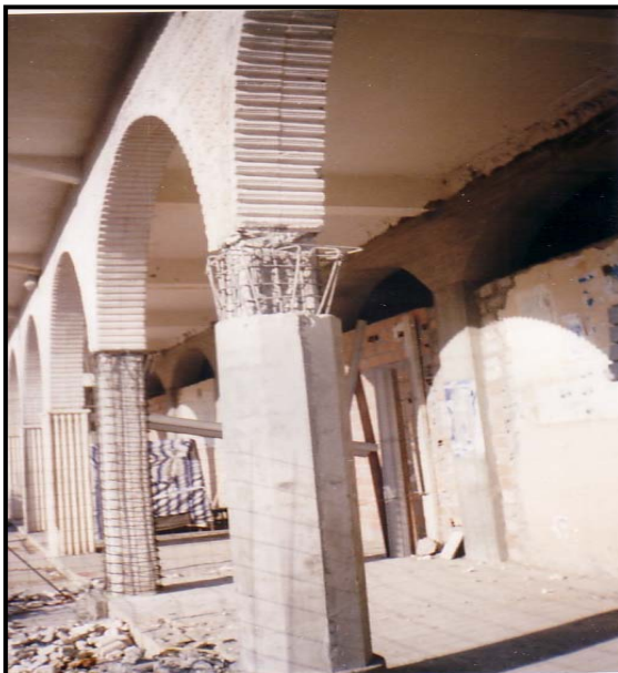
PhotoVII.4: Etat du poteau après décoffrage du poteau
