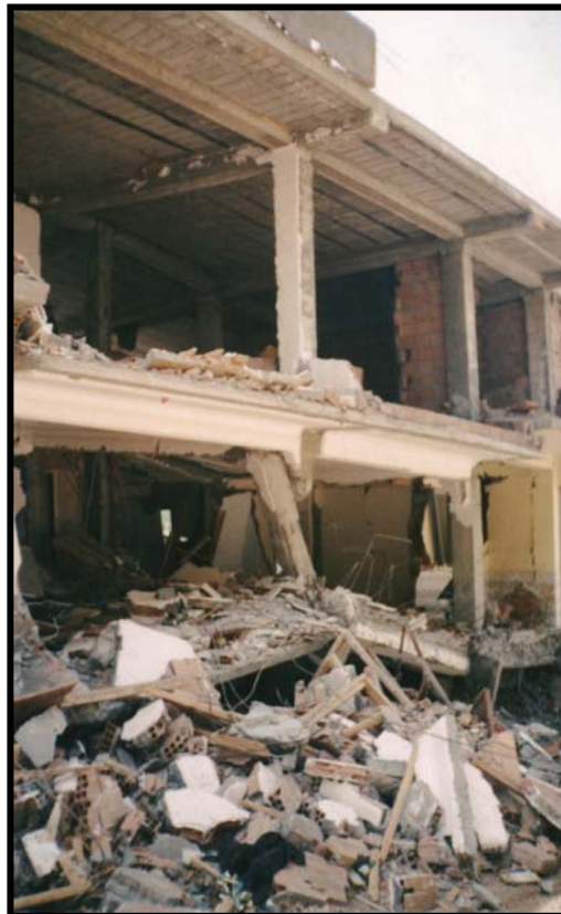
PhotoV.26: Poteau de rive détérioré complètement, le plancher haut resté intact.
