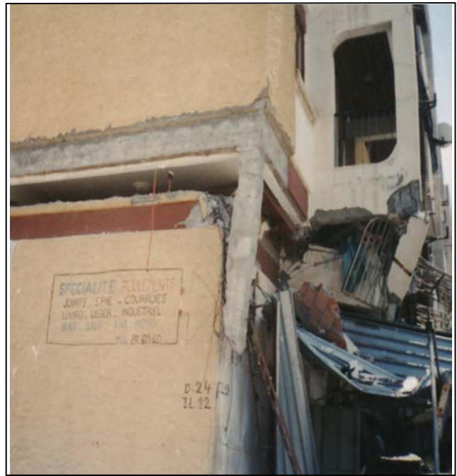
Photo IV.10: Cisaillement affectant un poteau d'angle à sa partie inférieure
