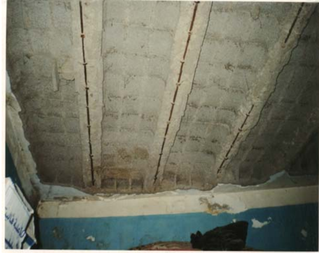
PhotoVI.2: Chute d'une partie en corps creux
