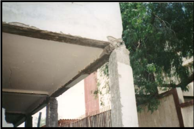
PhotoV.23: Le plancher haut du rez- de-chaussée est resté intact.
