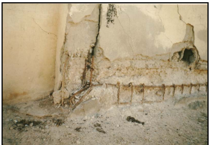
PhotoV.40: Détérioration de la longrine et du poteau par l'attaque des sulfates
