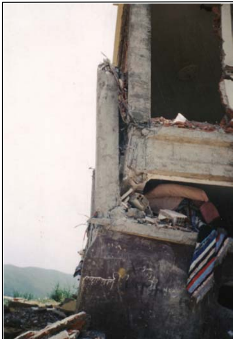
Photo IV.9: Cisaillement affectant un poteau d'angle à sa partie supérieure
