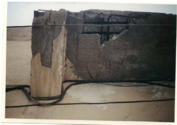
PhotoVI.5: Début de fissuration du béton
