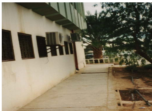
Photo V.14: Un dallage en béton prévu tout autour d'un bâtiment reste nécessaire.
