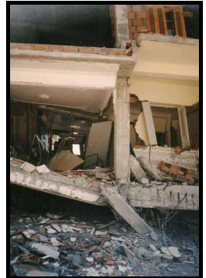
PhotoV.27: Destruction du Poteau RDC, le plancher du niveau 1 est intact.
