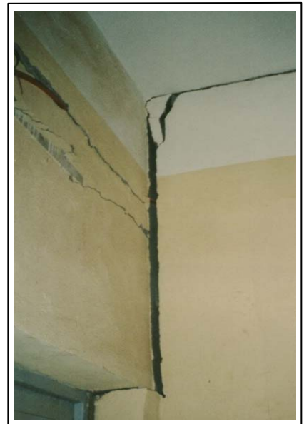
Photo IV.2: Fissuration verticale et horizontale au niveau des murs cloisons provoquant leur décollement du poteau, de la poutre et de dalle.
