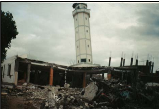
PhotoV.34: Minaret de la mosquée de Zemmouri en voie d'effondrement (au moment de la réplique).
