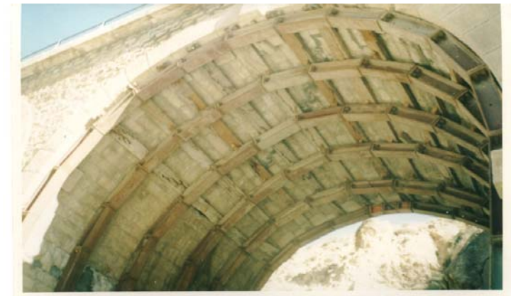
PhotoVII.17: Procédé de renforcement de l'extrados de la voûte permettant ainsi une bonne transmission de la charge à la structure additionnelle. El-Kantara (Biskra).
