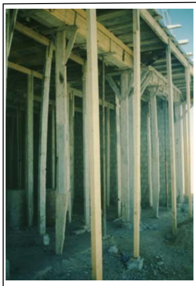
Photo V.11: Un ensemble d'étais Mis en place sans contreventement
