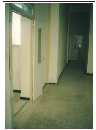
Photo V.5: Mauvais choix de l'emplacement du joint de dilatation.
