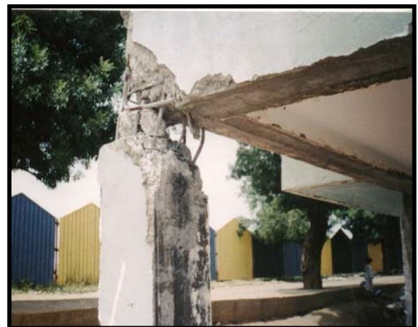
PhotoV.22: Malgré la destruction de l'extrémité du poteau, les poutres sont en équilibres.
