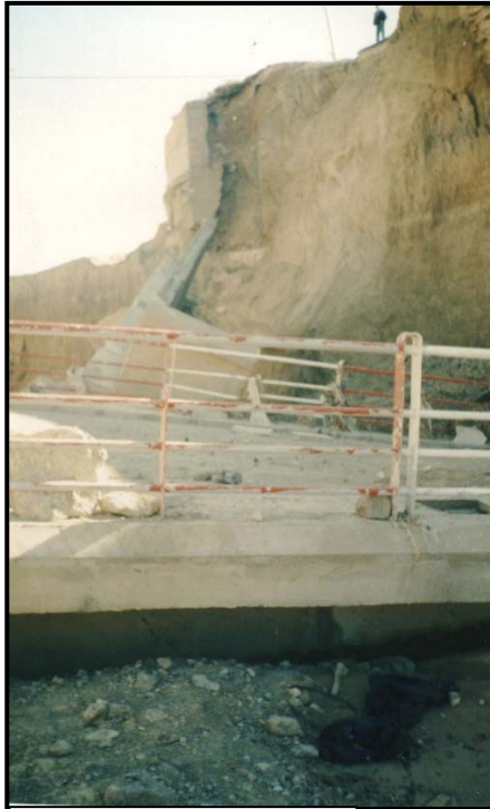
PhotoV.43: Le tablier du pont de Ain-Touta au fond du lit d'oued ( cause:affouillement du sol de fondation)
