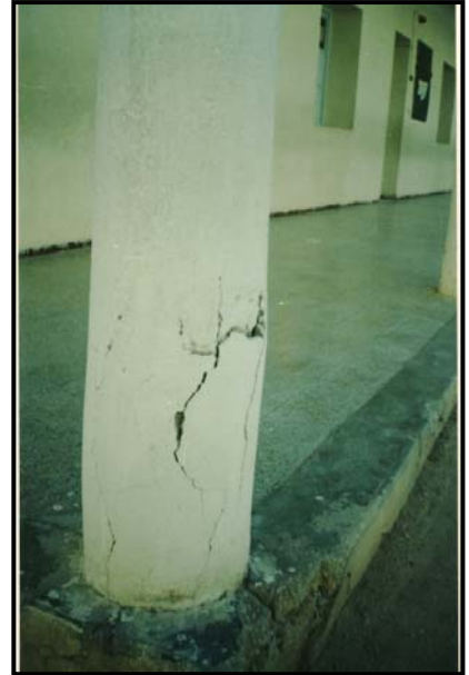
PhotoV.42: éclatement du béton au niveau du pied de poteau.
