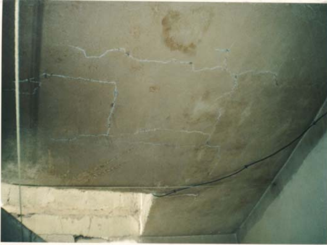
PhotoVI.1: début de fissuration d'un plancher
