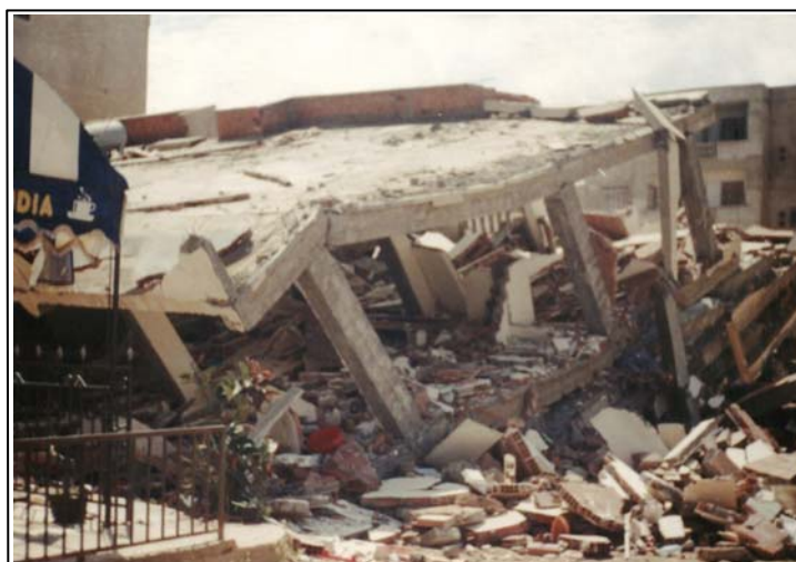
Photo IV.12: Destruction de la structure en béton armé
