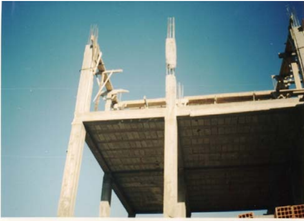
PhotoVI.9: Ségrégation du béton excès d'eau
