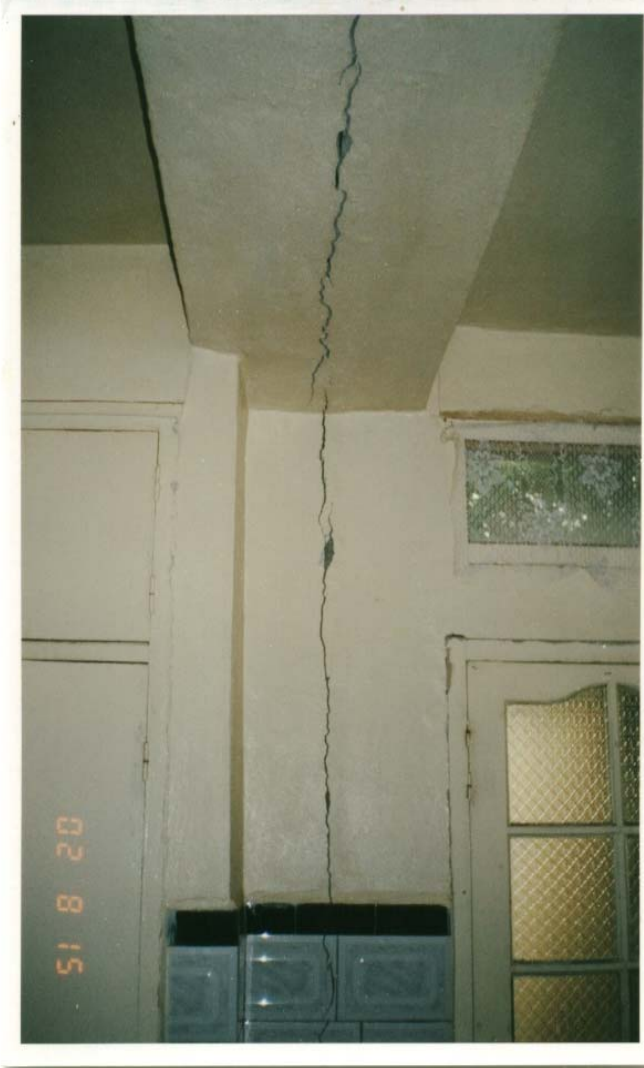
PhotoVI.11: La partie de la construction située à gauche de la fissure a été réalisée en 1982, tandis que la partie située à droite de la fissure a été réalisée en 1997 sans la prise en compte de dispositions nécessaires ce qui a provoqué la fissuration.
