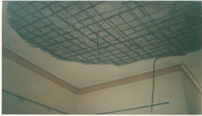
PhotoVI.3: Détérioration de la dalle
