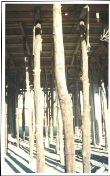
Photo V.8: Etais en bois présentant une déformation.
