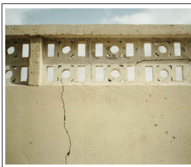
Photo IV.7: Fissure verticale au niveau d'une clôture en parpaing de 20 cm d'épaisseur.
