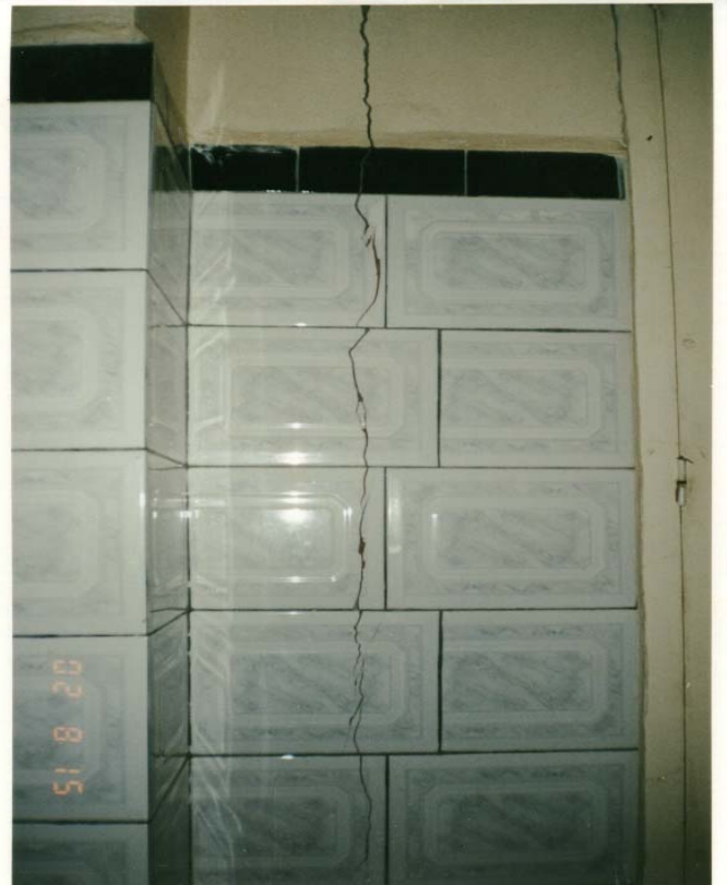
PhotoVI.12: La fissure a pu connaître sa position réelle même à travers le revêtement en céramique, l'état de la fissure nous justifie que c'est un tassement différentiel qui s'est produit.
