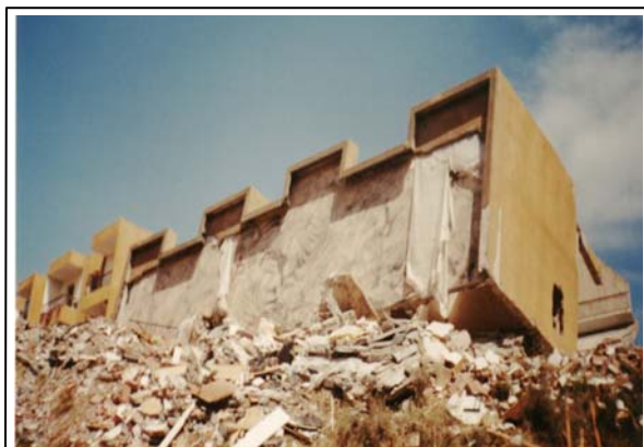
Photo IV.4: Renversment d'un bâtiment à usage d'habitation de niveau R+3
