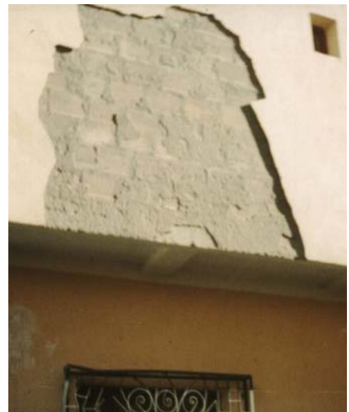
Photo III.2: Décollement de l'enduit d'un mur dû à une insuffisance d'accrochage.
