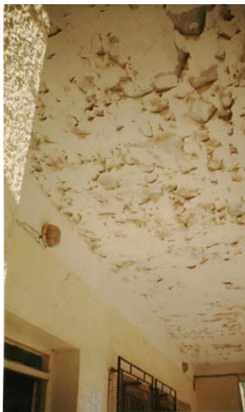
Photo III.1: Décollement de la peinture d'un plafond dû aux infiltrations d'eau pluviale.
