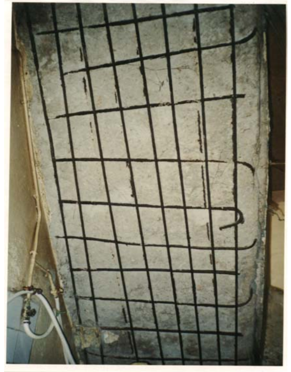
PhotoVI.8: Corrosion des aciers "escalier"
