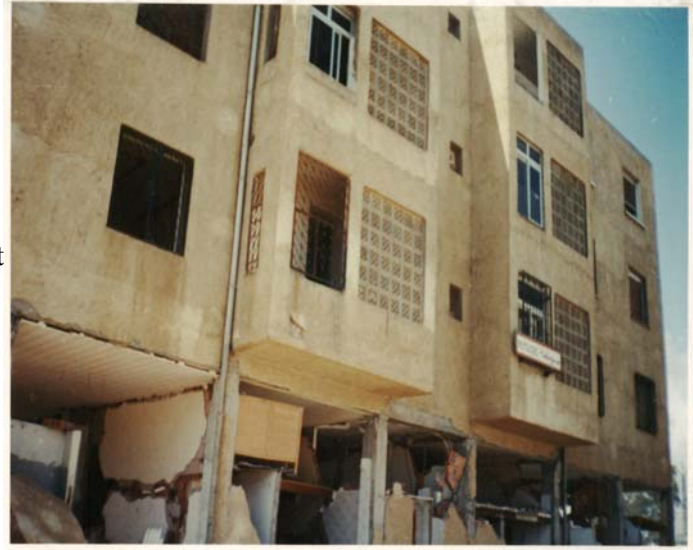
Photo III.3: Bâtiment dégradé partiellement
