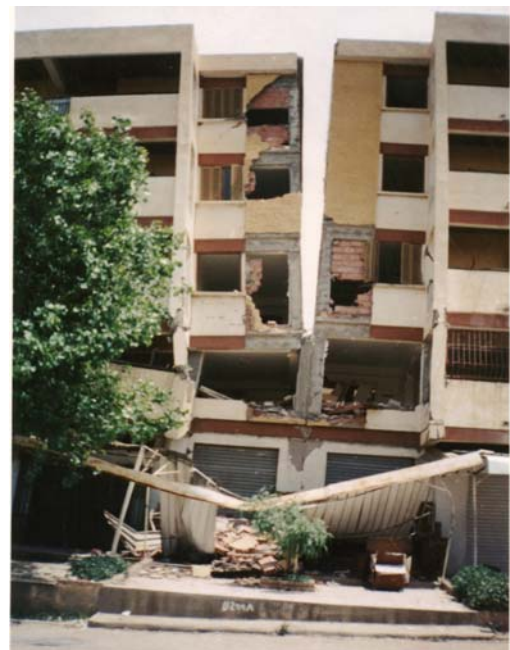
PhotoV.31: L'ouverture du joint concerne la partie supérieure des bâtiments
