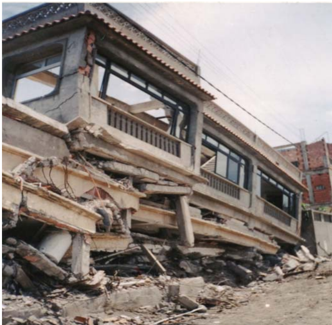
Photo III.4: Construction à usage d'habitation mise en ruine lors du séisme survenu le 21/05/2003 dans la région de Boumerdes
