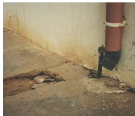
PhotoV.15: L'existence d'une crevasse sous la conduite d'eau pluviale peut être la cause de sinistre.
