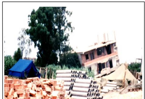
Photo IV.3: Basculement d'une construction à usage d'habitation provoquant un faux aplomb
