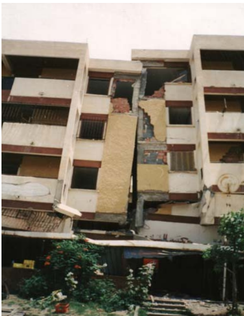
PhotoV.30: L'ouverture du joint est limitée seulement à la partie inférieure des bâtiments.
