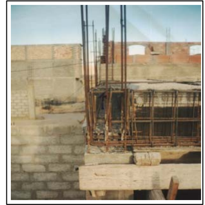
Photo:V.6: Absence d'armatures transversales au niveau du nœud (poteau- poutre)
