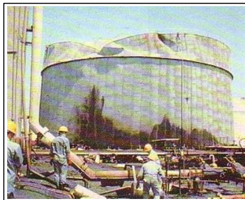
Photo V.13: La déformation d'un réservoir métallique survenue au moment de la vidange [1*]
