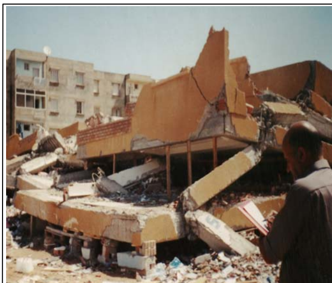
Photo IV.5: Destruction totale d'une construction à usage commercial
