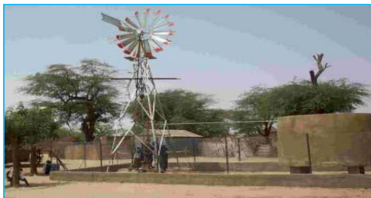
Fig. II.4 Turbine éolienne de pompage - Mauritanie ' lente'
