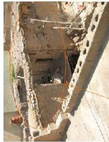
Partie en ruine
