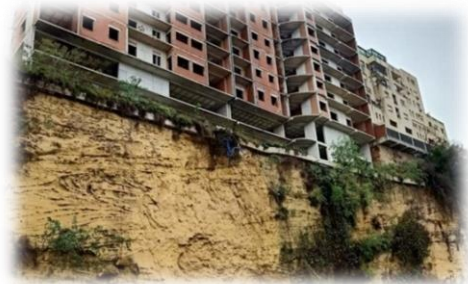
Figure N° 37 : Photo de glissement de terrain
