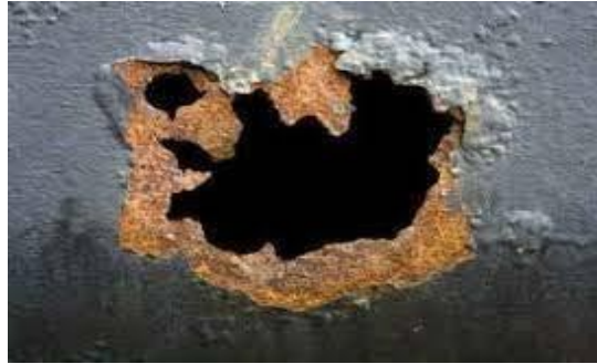
Fig I.5: Corrosion par piqure
