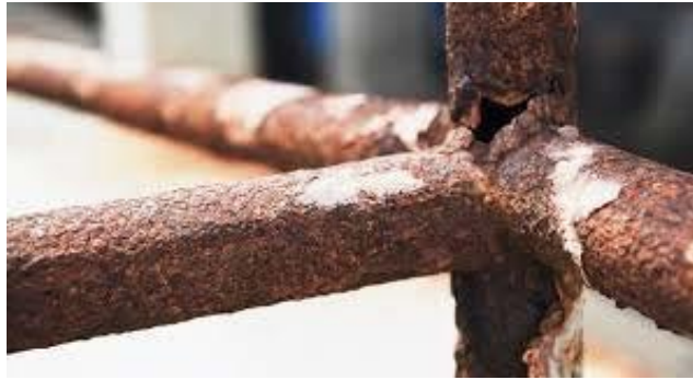
Fig I.1 : photo de matériaux soumis aux phénomènes de corrosion.
