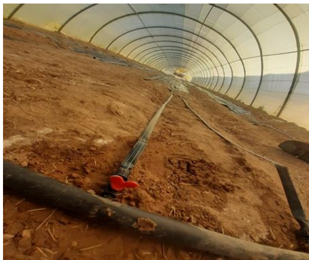
Photo 10: installation de système goutte à goutte
