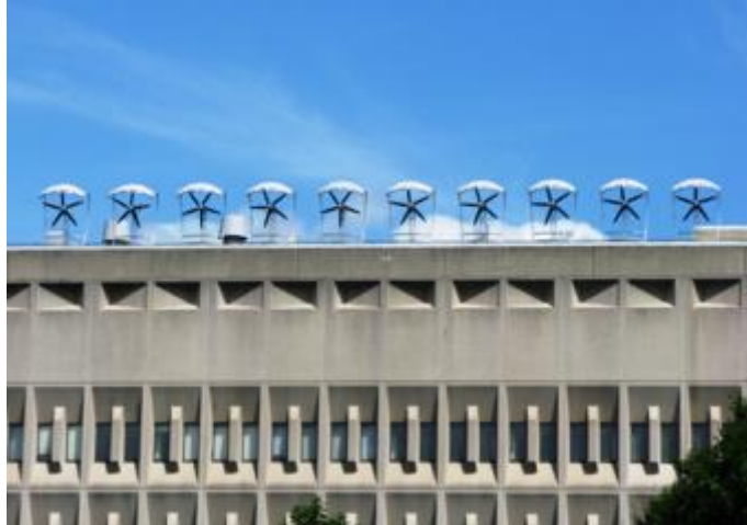
Figure 43: Un projet pilote visant à tester l'énergie éolienne a été installé sur le toit du Becton Engineering and Applied Science Center en mars 2009. Source : (Energy | Yale Sustainability, 2023.)
