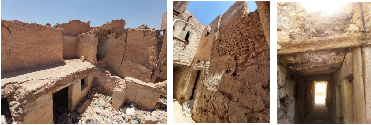
Fig.89 : L'état de dégradation ou démolition des habitations et les rues couvertes. Source l'auteur 2020
