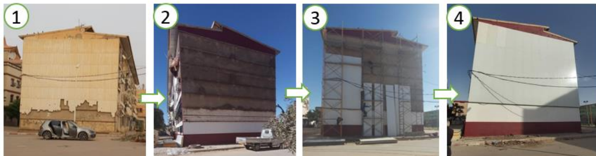
Fig.98 : Photos avant et après l'utilisation des panneaux sandwichs pour le respect de l'aspect architectural de climat et de conception dans les logements cité Silis. Source : Éditée par l'auteur, 2019.
