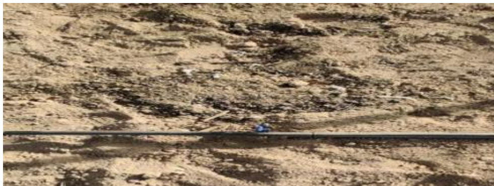
Figure 10 : Installation de su système d'irrigation (Originale)
