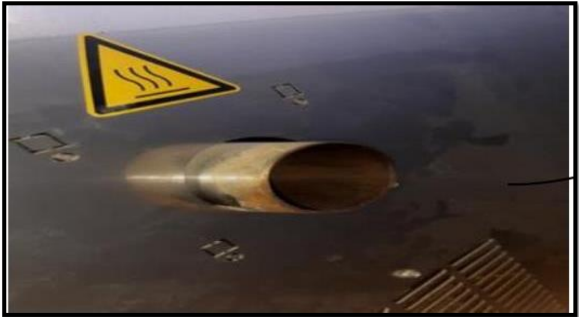
Figure II.10 : Un ventilateur d'extraction d'air chaud de l'intérieur du Etuve de séchage Naberterm (30_3000°C).
