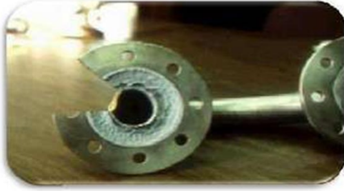
الشكل (6.1): صورة للتآكل الشقي [17].
