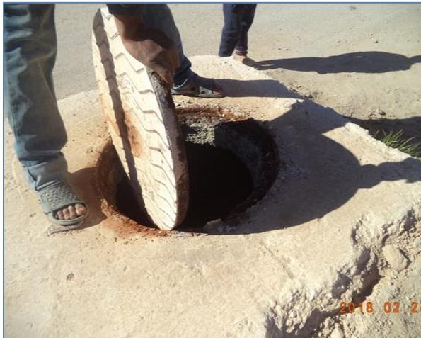
Figure II.9. L'opération d'ouverture des tampons.
