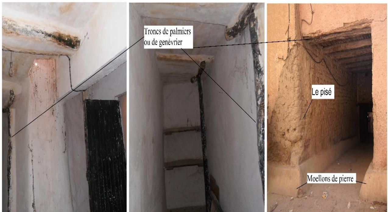
Fig.IV.16: le procédé constructif traditionnel dans les maisons de la médina de Bou-Saada.
