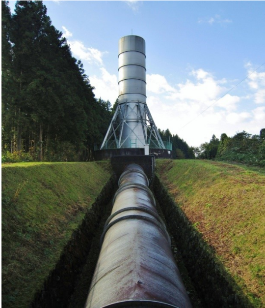
Figure 5.21 : Photo d'une cheminée d'équilibre
