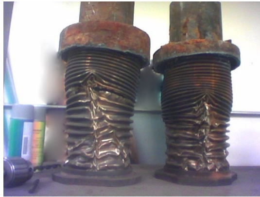
Figure 5.13 : Joint de dilatation détruit par un coup de bélier
