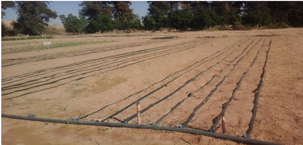
Figure 11: photo de l'installation du système d'irrigation.
