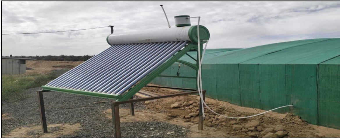
Figure(11) : chauffage solaire de l'eau Sidi Okba
