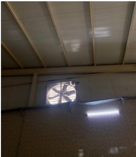
Figure 52: Ventilation et rafraîchissement de l'air
