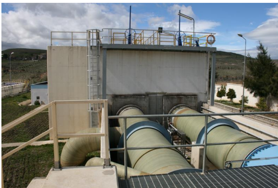
Figure III.1 : Dégrillage Source : (le site de la société de l'eau et de l'assainissement de Constantine°) Traitement des refus de dégrillage :
