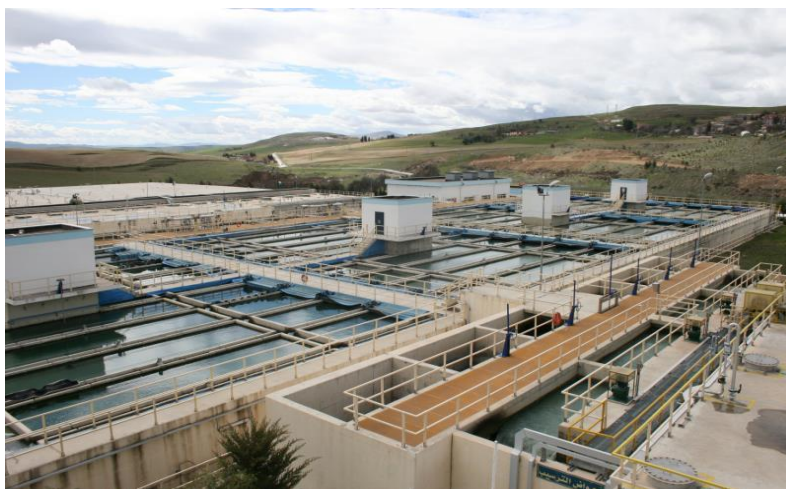
Figure III.2 : Dessablage-déshuilage Source : (le site de la société de l'eau et de l'assainissement de Constantine°)Pompe à sables
