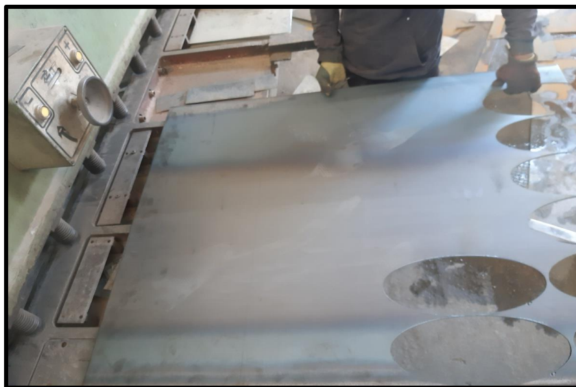
Figure III.1: Photographie numérique montrant la plaque métallique
