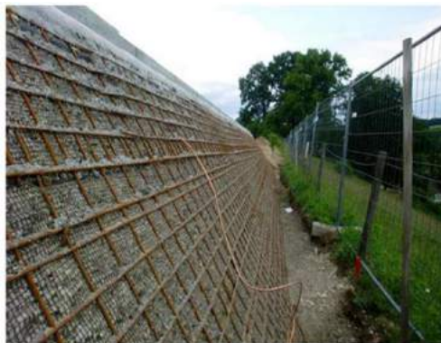
Figure II.15 : mur en terre armée.[18]
