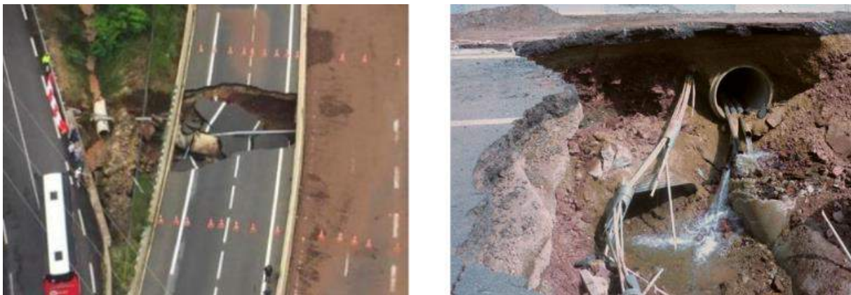
Figure II.2 : Effondrement d'un remblai autoroutier sur l'A75 suite à l'érosion des matériaux contigus à un ouvrage hydraulique lors d'un épisode pluvieux particulièrement intense.(Sources : Figure de gauche - Détachement Aérien de Gendarmerie de Montpellier - Figure de droite, DIR MED [12])
