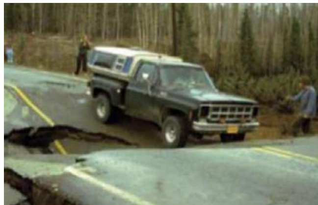
Figure I.11 : Exemple de rupture par poinçonnements du remblai sur sol compressible [4]
