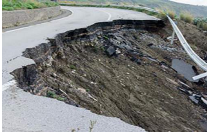
Figure I.12 : Exemple de rupture rotationnel sans fissuration[4]
