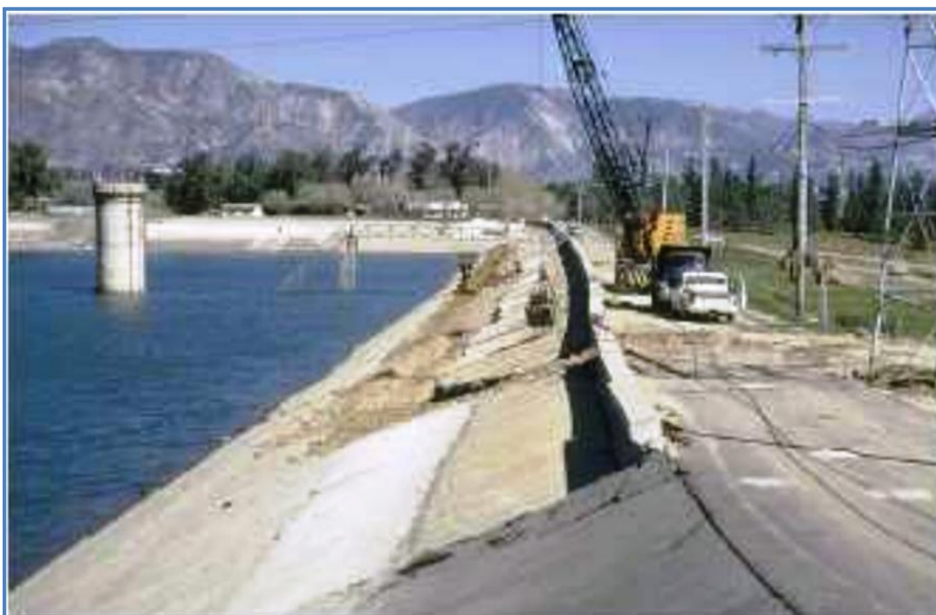
Figure 2.10 : Barrage supérieur de San Fernando après le séisme de 1971. [11]
