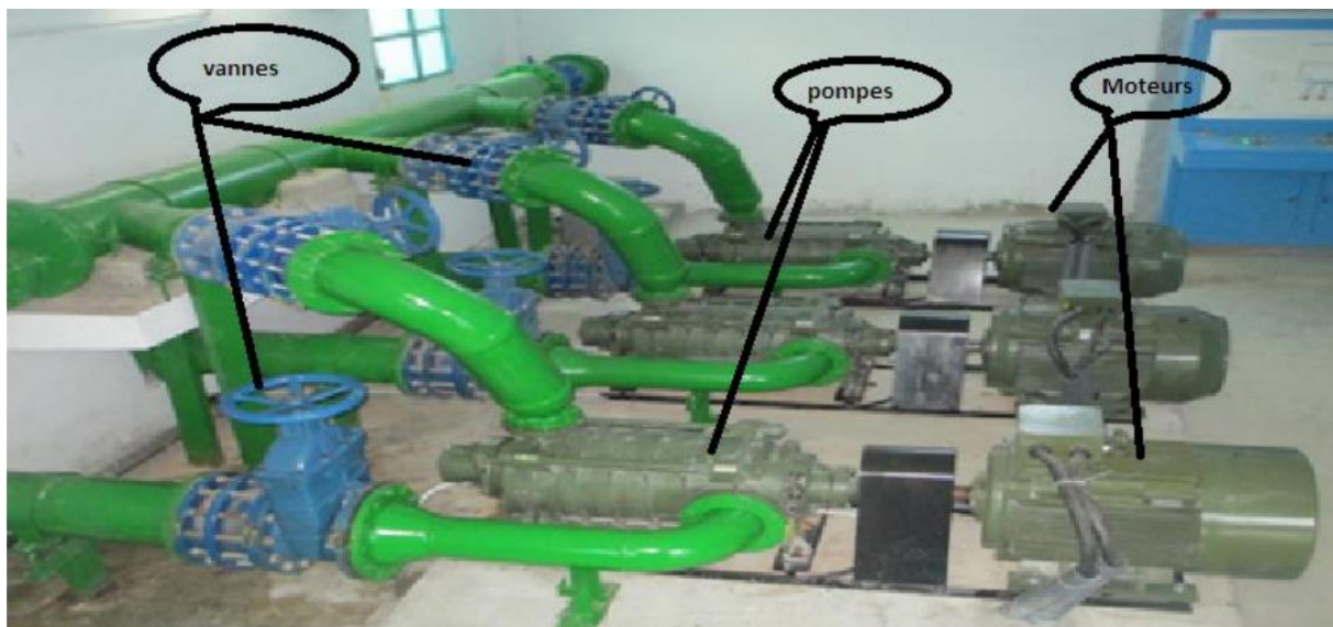
Figure 3.2 : Vue d'un groupe électropompe.
