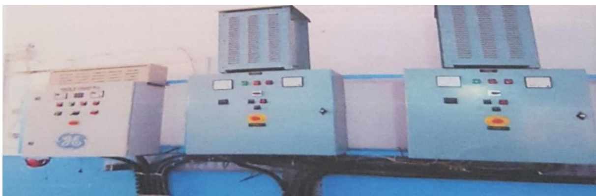
Figure 4.1 : Vue des armoires de commande
