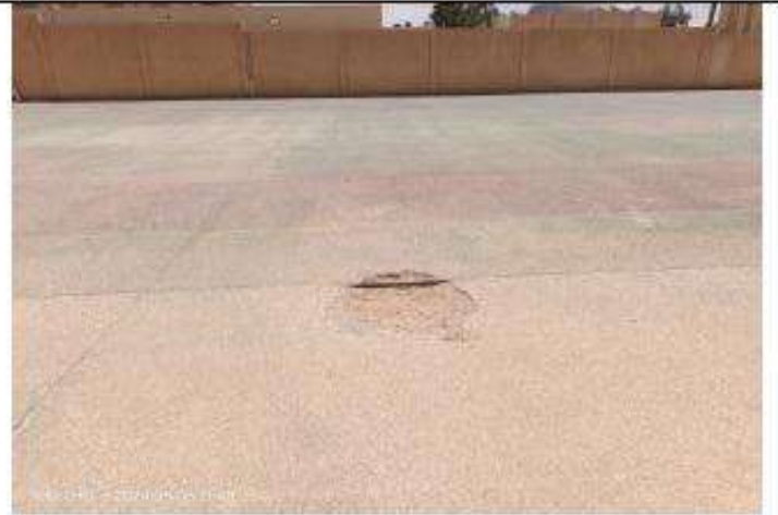
حفر في الأرضيات الاسمنتية (نسبة الخطر إشارة حمراء)
