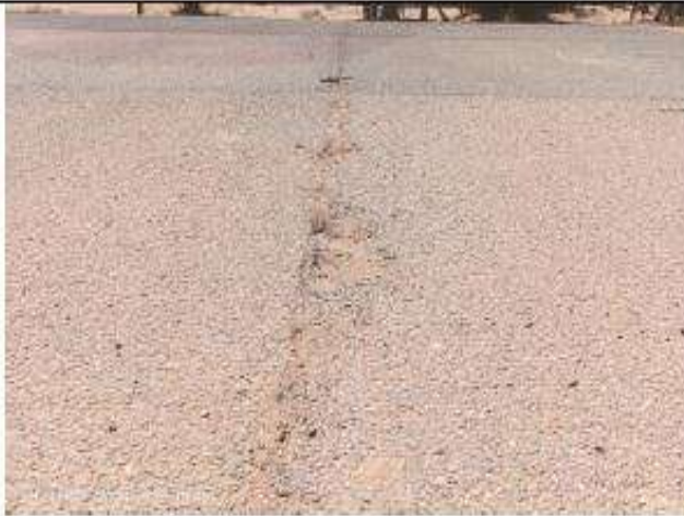
حفر أخرى وتآكل أرضية الملعب الاسمتي
