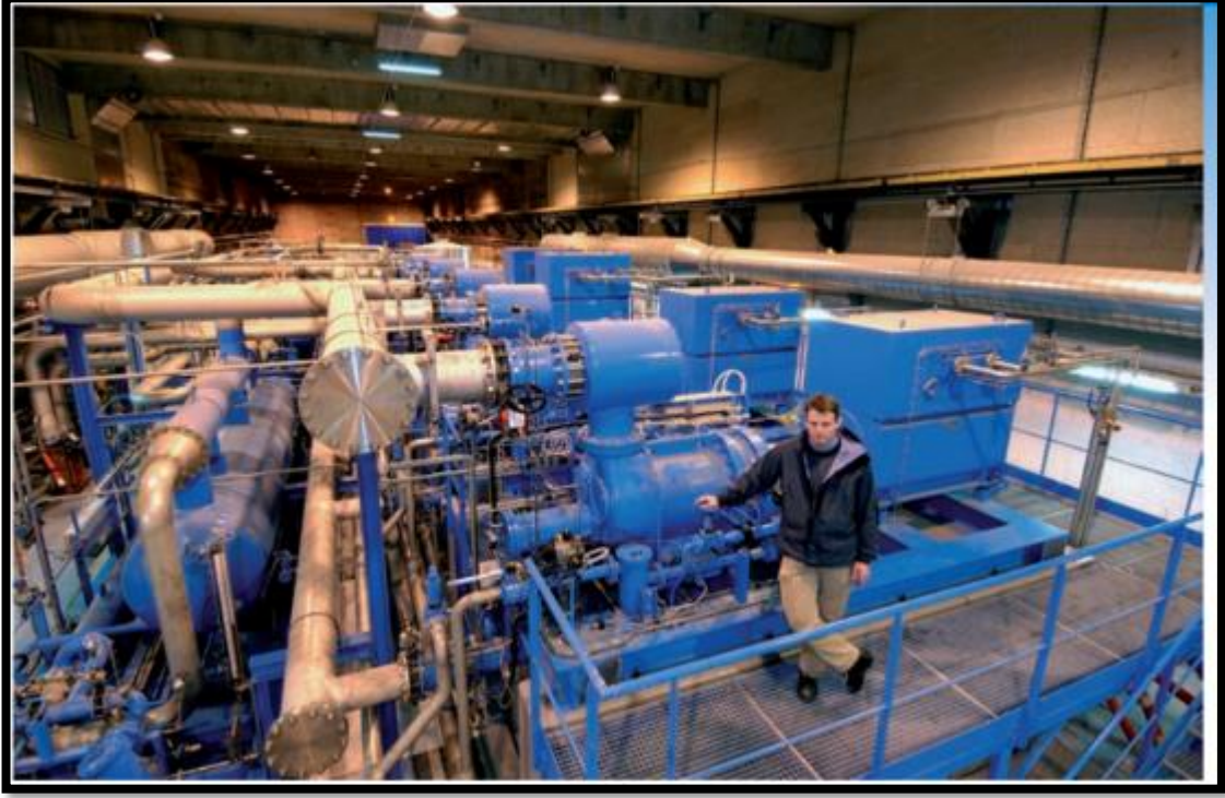
الشكل (9. III) ضواغط لولبية مشحمة في نظام التبريد LEP في CERN .
