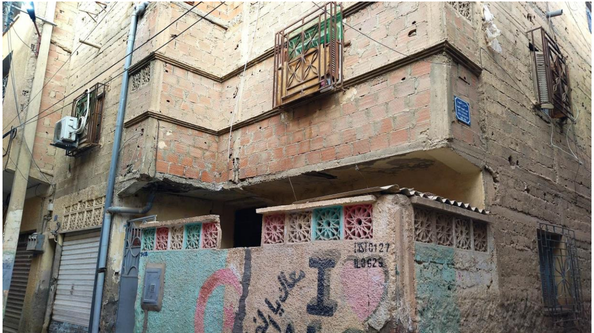
FIGURE 20: CARACTERISTIQUES DE DEGRADATION LIEE PAR LA CONSTRUCTION ANARCHIQUE A HAI LEMSSALA
