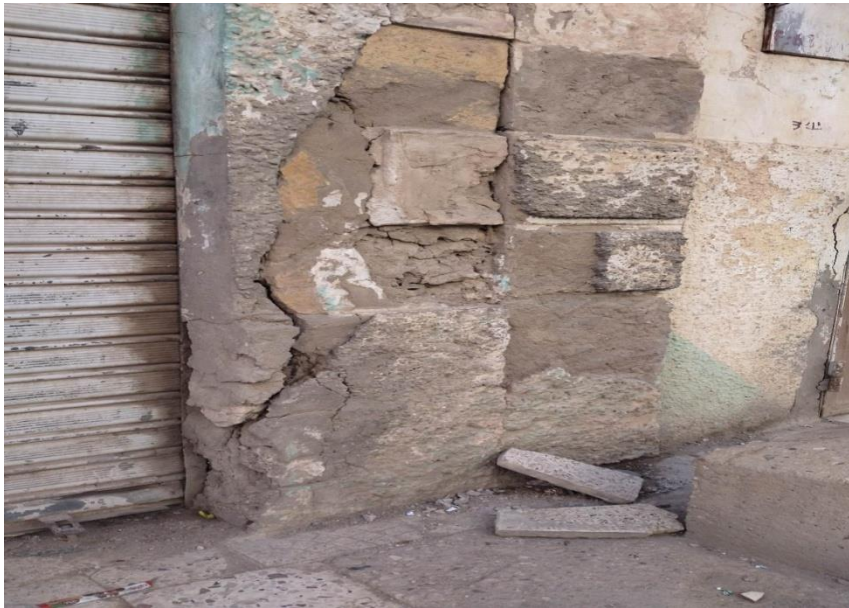
FIGURE 23 CARACTERISTIQUE DE DEGRADATION LIEE A L'ECAILLAGE DES MATERIAUX A HAI SATR LMLOUK
