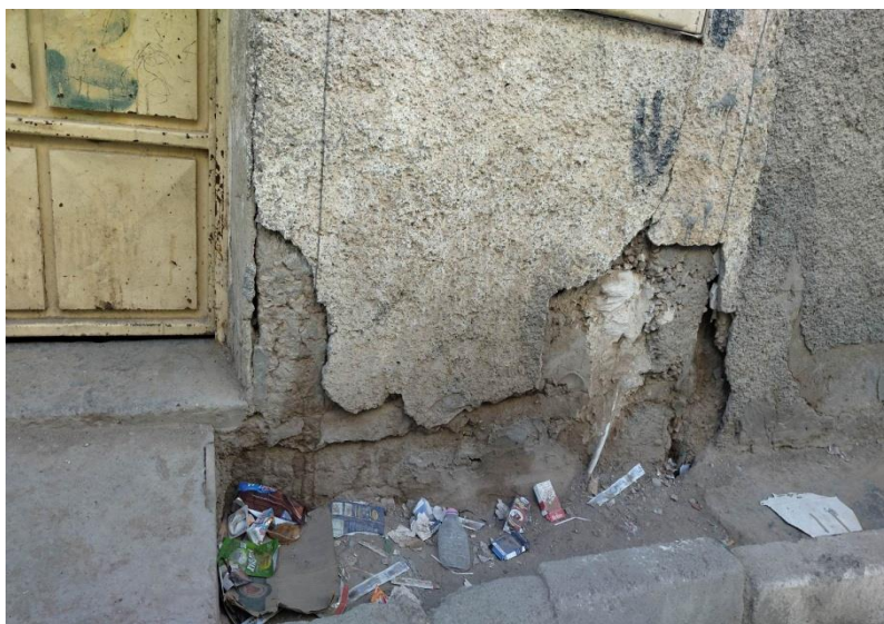
FIGURE 26 CARACTERISTIQUE DE DEGRADATION ASSOCIEE A LA MAUVAISE QUALITE DE L'EXECUTION ET LA NEGLIGENCE DE L'ENVIRONNEMENT A HARET EL OUED SUD
