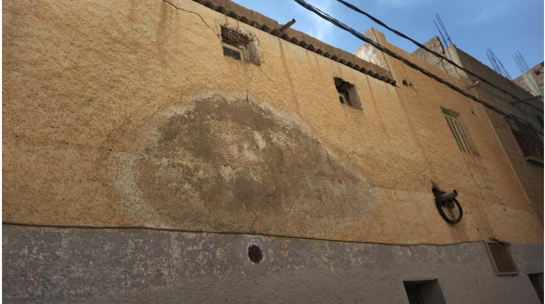
FIGURE 27: CARACTERISTIQUE DE DEGRADATION LIEE A L'ABSENCE DE L'ENTRETIEN HAI BOUKHARI
