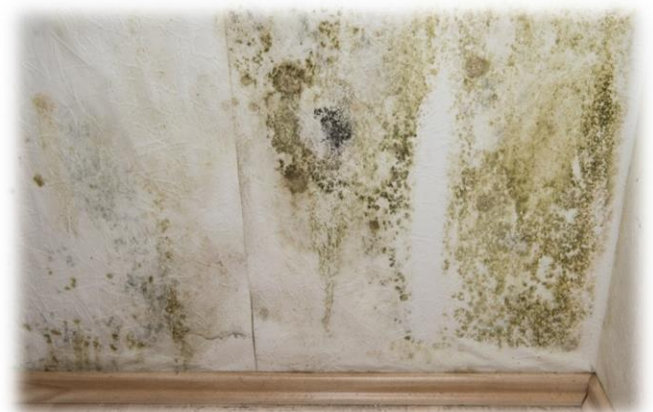
FIGURE 4 : MOISSURE SUR LE MUR
