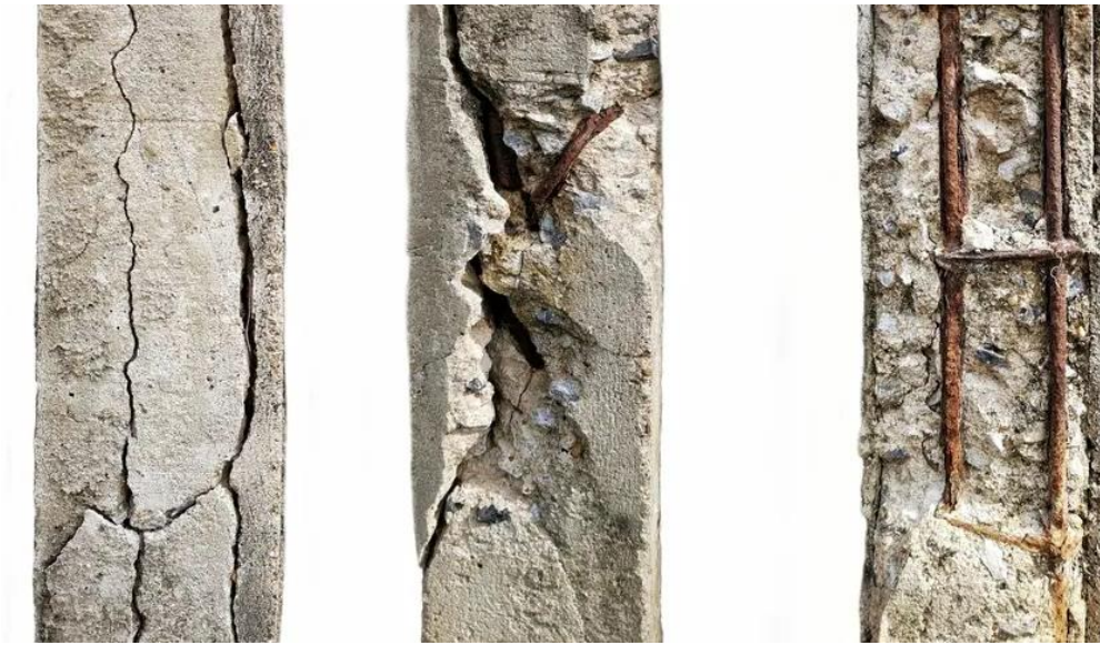
FIGURE 6 :CROISSON SUR UN POTEAU
