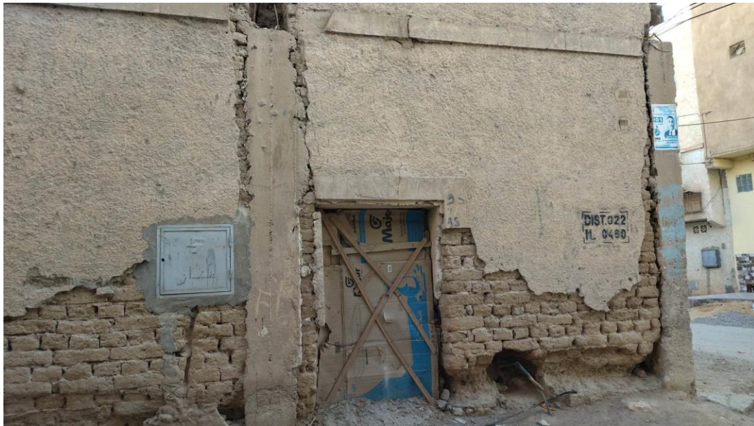
FIGURE 24 CARACTERISTIQUES DE DEGRADATION ASSOCIEES UNE MAUVAISE STABILITE STRUCTURELLE A HAI HARET EL OUED-NORD
