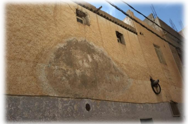
FIGURE 3 : HUMIDITE DE LA FAÇADE
