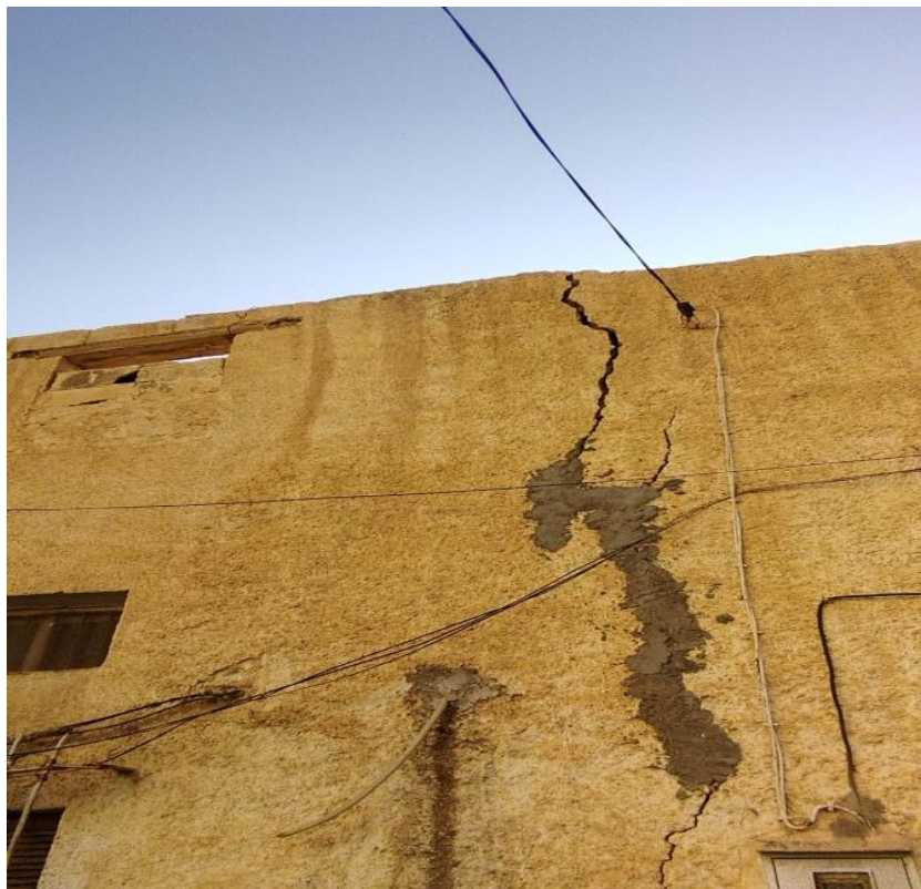
FIGURE 22 CARACTERISTIQUE DE DEGRADATION LIEE AU DEFAUT DE CONSTRUCTION A HAI BILAL
