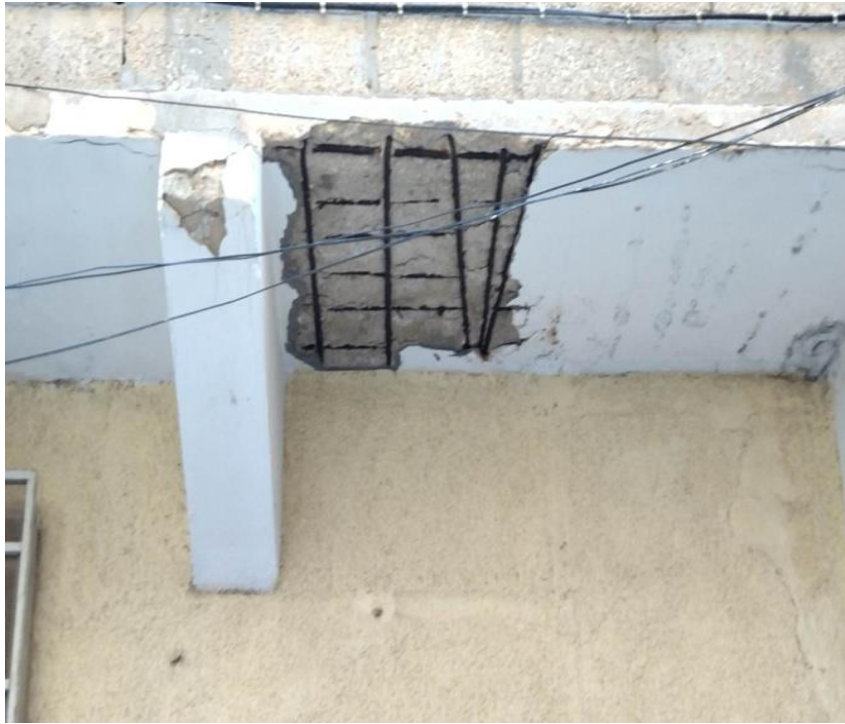
FIGURE 19: CARACTERISTIQUE DE DEGRADATION LIEE A UNE MAUVAISE MISE EN ŒUVRE A HAI LEMSSALA
