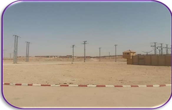
الصورة (2-3): الخطوط الكهربائية متوسطة
