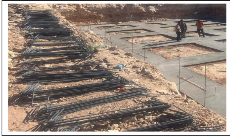
Figure.1.9. Mauvais stockage de ferrailage
