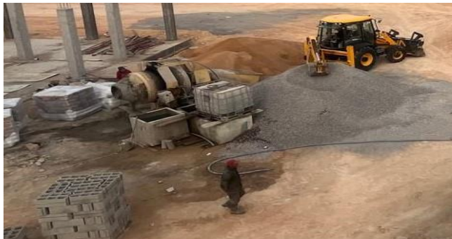
Figure.1.13. Mauvais stockage de sable et gravier au chantier.
