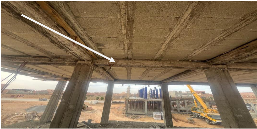
Figure.1.45. Ségrégation dans la Poutre après décoffrage.
