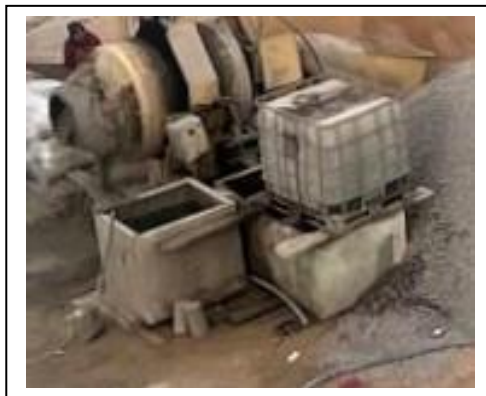
Figure.1.14. Réservoir de stockage d'eau dans le chantier.
