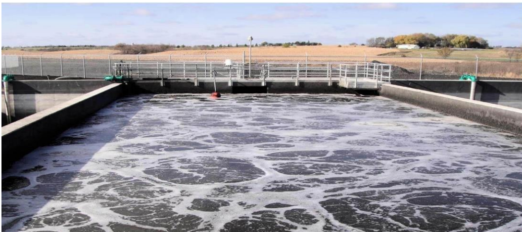
Photo III.9: Les bassins d'aération de la station
