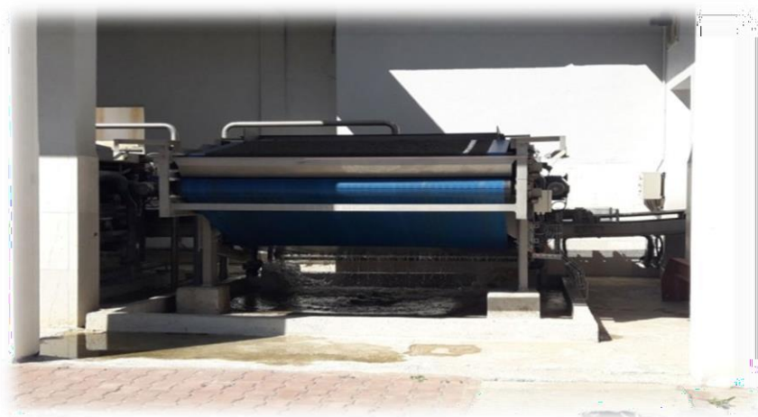
Photo III.16: Déshydratation des boues de la STEP d'Arris le filtre à bandes presseuse.
