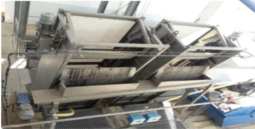
PhotoIII.4 : Dégrillage grossier de la STEP.
