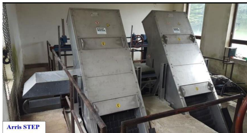
PhotoIII.5: Dégrillage fin de la STEP
