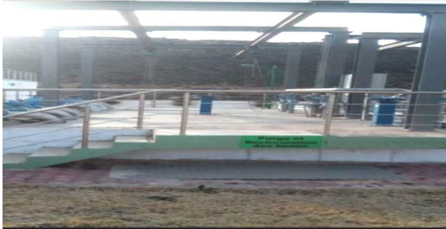
Photo III.12: Les groupes d'électropompes destinées pour le pompage des boues en excès et des boues de recyclage.
