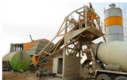
Centrale à béton
