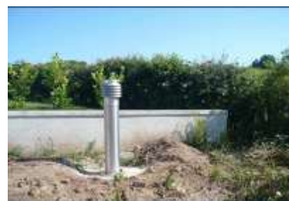
Figure 14: La prise d'entrée de l'air neuf. Source : tercha_hocine.pdf
