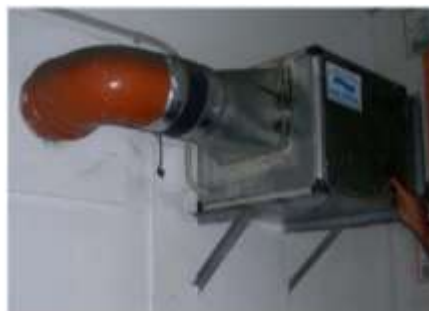
Figure 18: Point d'entrée de l'air provenant du tube géothermique dans le bâtiment. Source : Use of Earth to Air Heat Exchangers for Cooling.pdf
