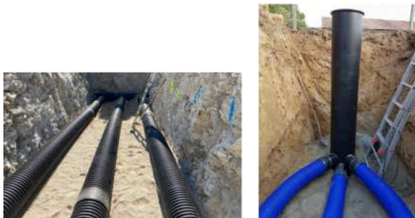
Figure 15: des photos réelles d'installation puits canadien. PuitsCanadienFede2019.pdf
