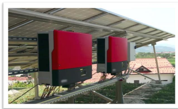
Figure (II.7) : Onduleur solaire
