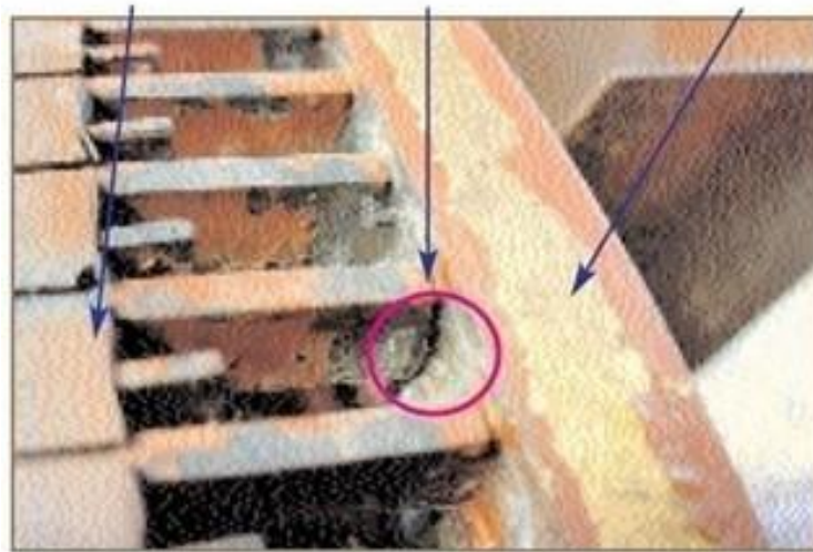
Fig 3.3: Fissure dans un joint entre la barre et l'anneau de court-circuit
