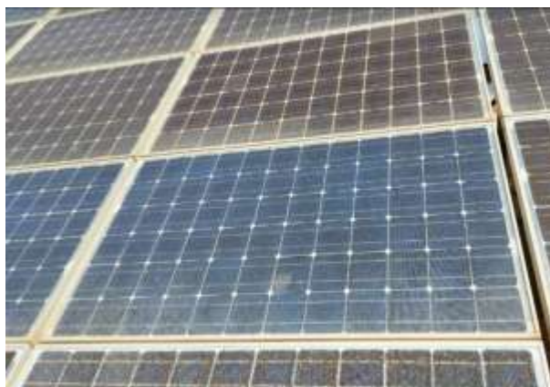
Figure III.7 : Détérioration du revêtement antireflet (ARC)
