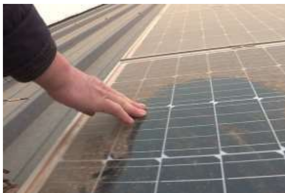
Figure III.18: Accumulation de poussière sur les panneaux
