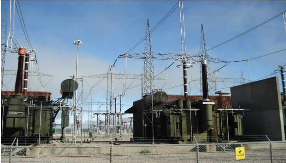
Figure. I.8 : ligne de transport [31]
