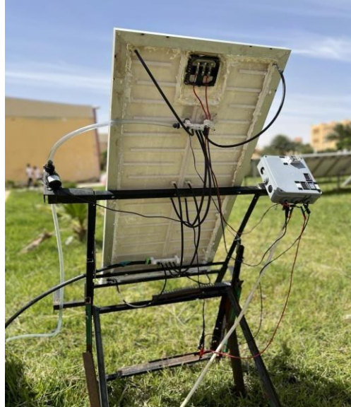
Figure III.18 : Mise en place et câblage final du système de pompage solaire avec système de refroidissement
