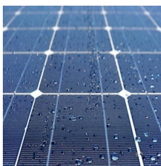
FIGURE III.1 – Nettoyage par pluie
