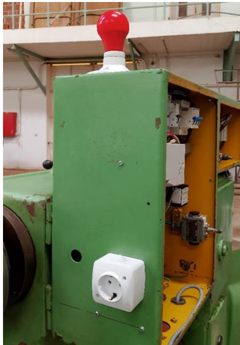
Figure III.28: Une prise et un lampe témoin pour indique que le tour est en marche.
