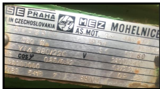
Figure III.12: La plaque signalétique de moteur M2.
