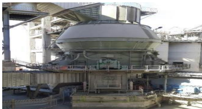
Figure I.25 : Broyage de ciment (VCM)
