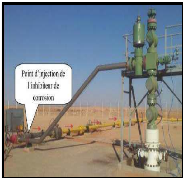
Figure II.11 : Point d'injection de l'inhibiteur de corrosion au niveau du puits.
