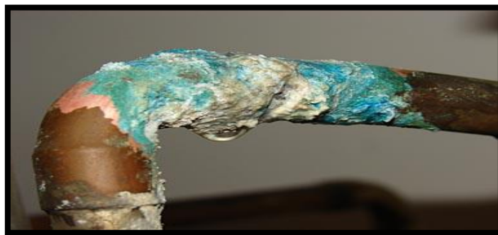
Figure I.1 : La corrosion chimique [2].
