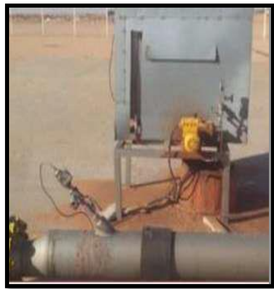
Figure II.12 : Pompe doseuse responsable à injecter l'inhibiteur de corrosion
