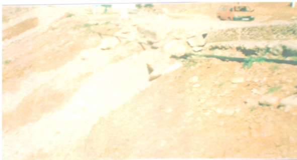
Photo iv-1 : affaissement du remblai coté aval.
