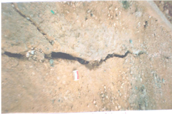
Photo iv-3 : fissure de la chaussée côté aval.
