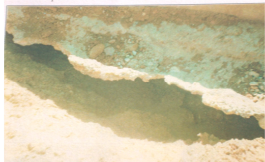
Photo iv-2 : mouvement du remblai sous les bordures.
