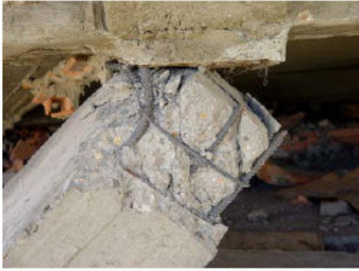
Fig. 5.18 Insuffisance d'armatures transversales, béton de mauvaise qualité, rupture au droit de la surface de reprise
