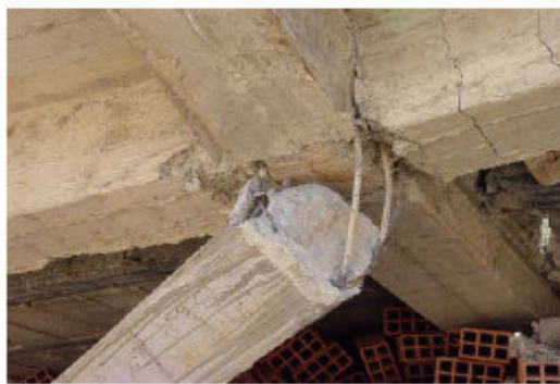
Fig. 5.19 Insuffisance d'armatures transversales, béton de mauvaise qualité, rupture au droit de la surface de reprise
