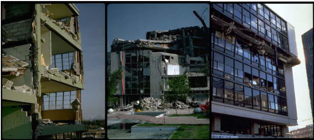
Figure I.3: Désolidarisation des façades, destruction des étages supérieurs, intermédiaires ou inférieurs
