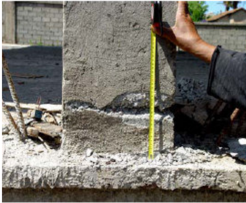
Fig. 5.15 Talonnette de 10 cm en mortier de très mauvaise qualité
