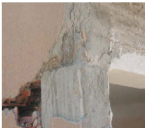
Photo 18. Absence d'armatures transversales en zone nodale et mauvaise réalisation du nœud
