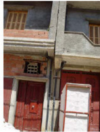
Fig. 10.7 Absence de joint entre les bâtiments
