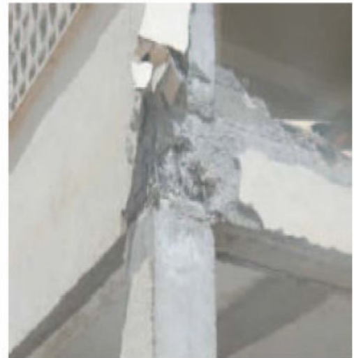
Mauvaise conception parasismique (poteau faible, poutre forte)
