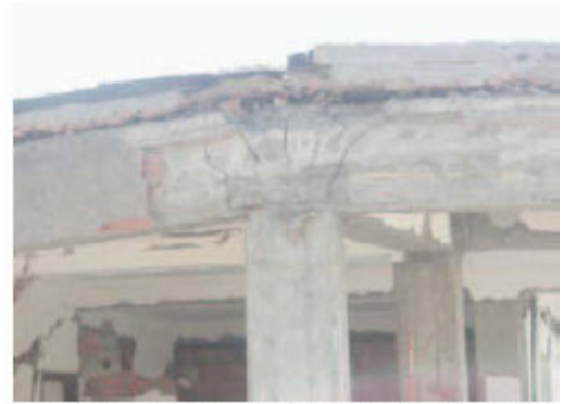
Photo N° 11. Mauvaise conception parasismique (poteau faible, poutre forte)
