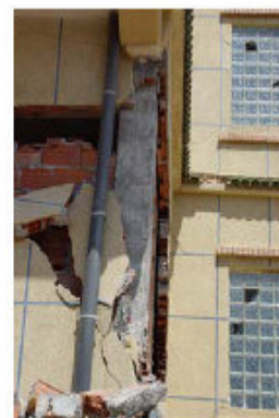
Fig. 10.6 Absence de joint entre les bâtiments
