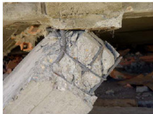
Fig. 5.18 Insuffisance d'armatures transversales, béton de mauvaise qualité, rupture au droit de la surface de reprise
