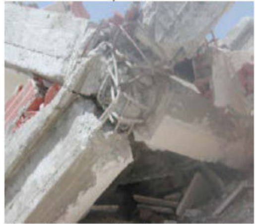
Photo 17. Absence d'armatures transversales en zone nodale
