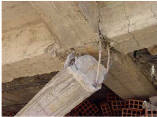
Fig. 5.19 Insuffisance d'armatures transversales, béton de mauvaise qualité, rupture au droit de la surface de reprise
