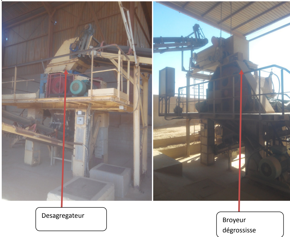
Figure 1.7 : convoyeurs entre les distributeurs et desagregateur et broyeur pré finisseur.
