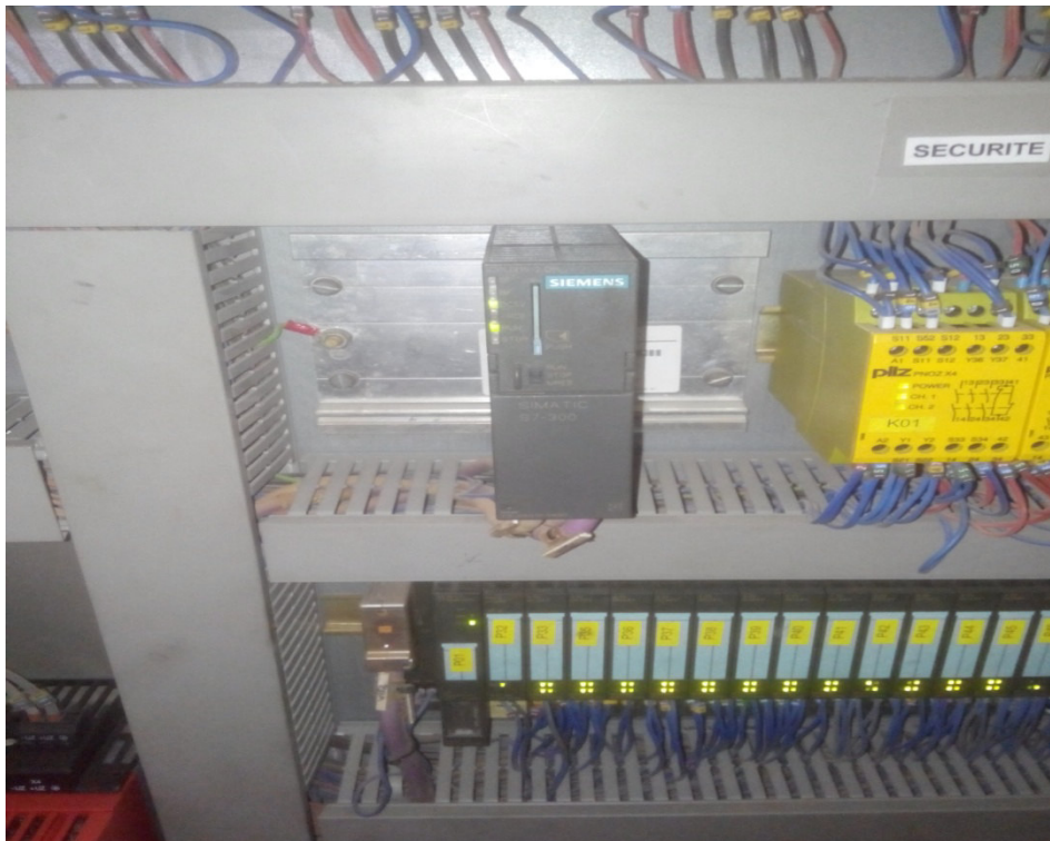
Figure3.14 :l'automate de la pince dp (siemens S7 300 15-2dp).
