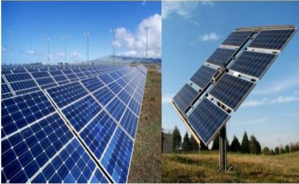
Fig(I.12) : Panneau photovoltaïque.
