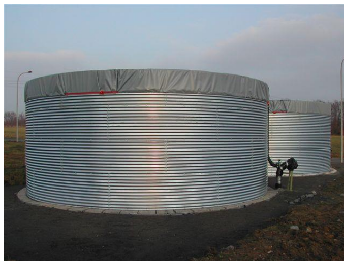
Fig 3.15 : réservoir de stockage d'eau
