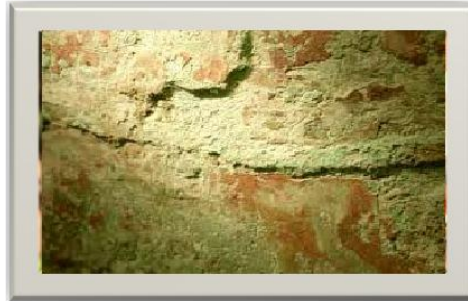
Figure 30 - La corrosion sélective
