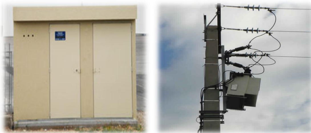
Figure 3.9 : Poste de transformation MT/BT
