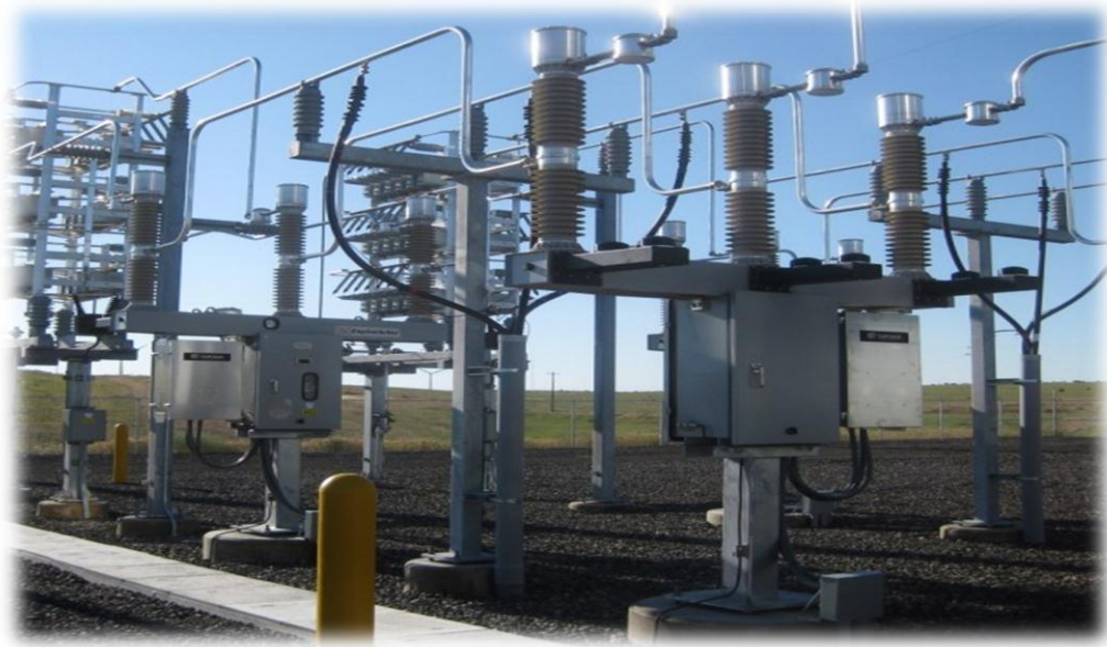
Figure 1.9 : Les bancs de condensateur
